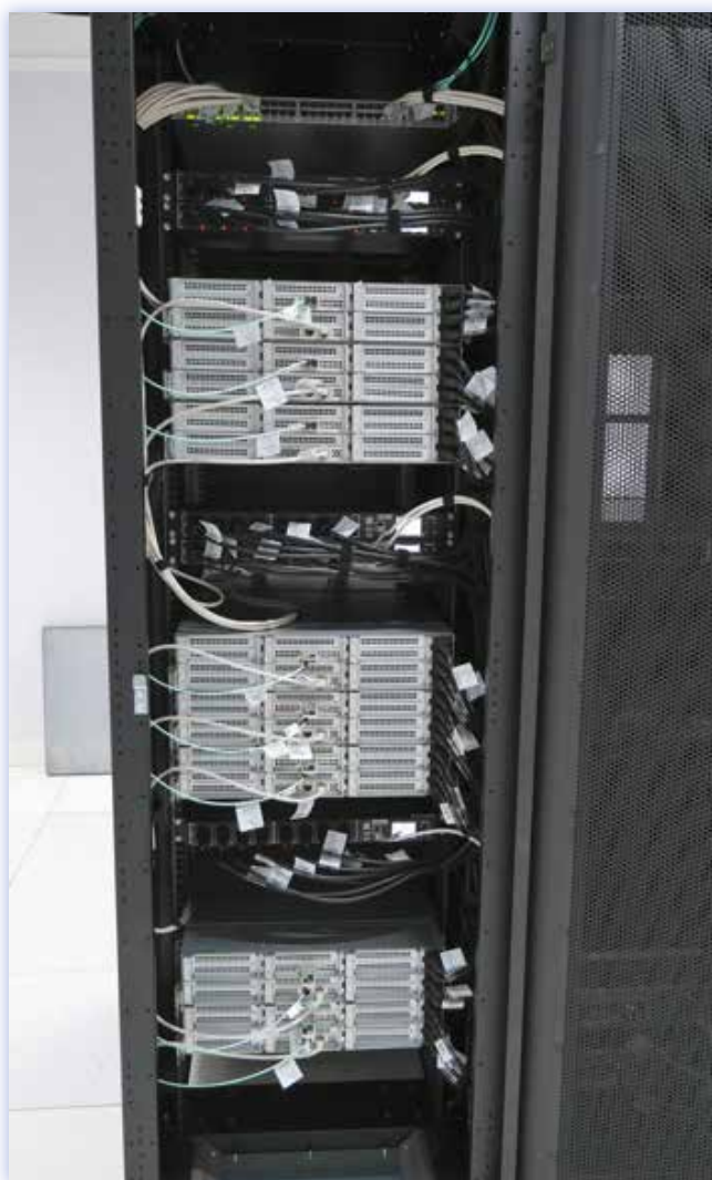
← Kelly , le prototype scalaire basé sur l'architecture ARM, installé au CEA DAM.
