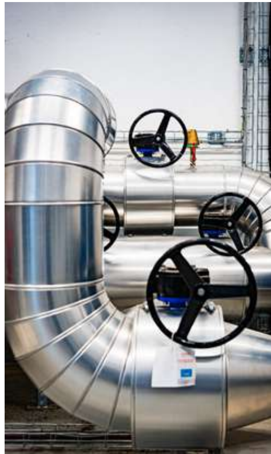
↑ Tuyaux de la sous-station pour la récupération de la chaleur fatale du supercalculateur Jean Zay.
